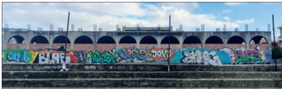
Ο τσιμέντινος σκελετός του Πνευματικού Κέντρου Αλίμου, όπως παραμένει εδώ και πολλές δεκαετίες.
